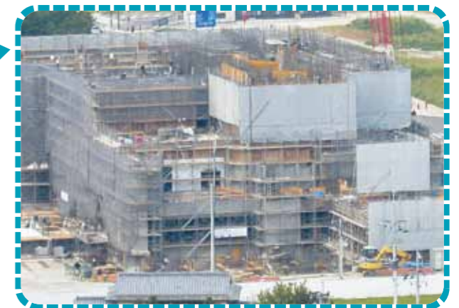
平成23年10月11日現在 地上躯体工事(高層部分の壁、床工事)が進んでいます。
